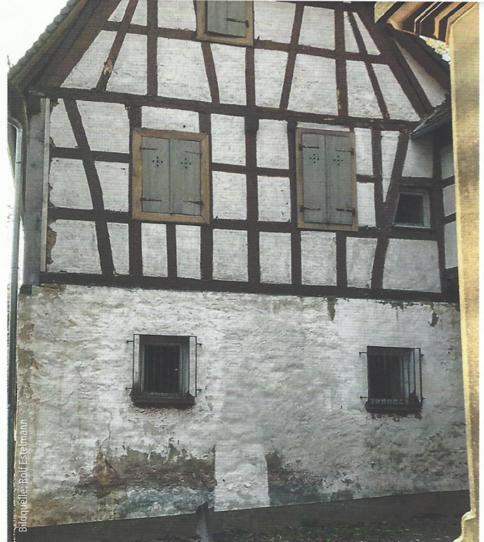
Abb. 3: Bei der Kolmerbergkapelle zeigte das Fachwerk der rückseitigen Giebelwand Zersetzungserscheinungen, nicht zuletzt durch Käferbefall.
