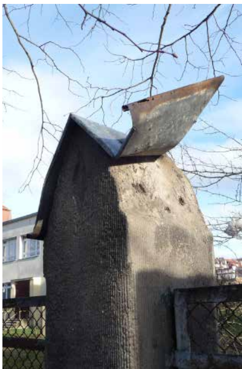
Uszkodzenia obróbek blacharskich i betonowych słupków.
