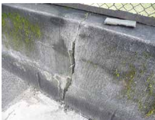
Spękania betonowej belki podwalinowej.
