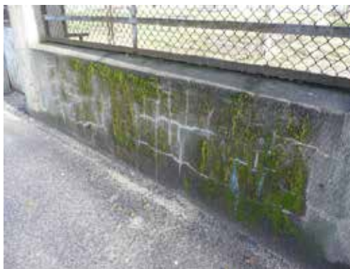
Mchy porastające powierzchnię muru.
